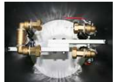
Innenraum des Schachtes STANDARD DUO
