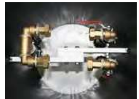
Innenraum des Schachtes STANDARD DUO
